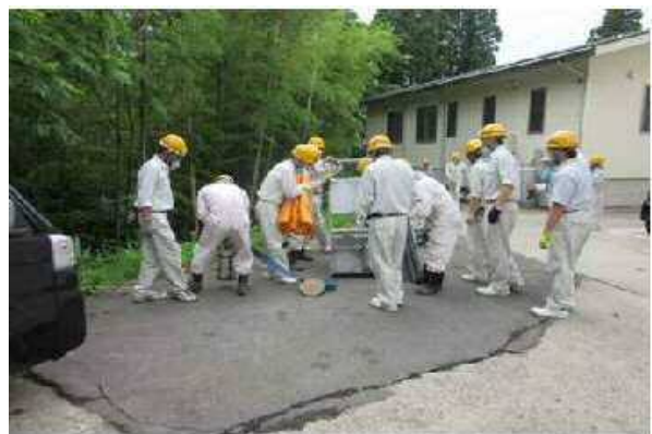
側溝への流出に備え重油回収用組立水槽設置
